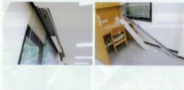
⑦ 図書館：空調ダクトの破損
