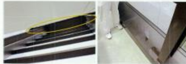
⑧ 総合管理棟：トイレ内壁面タイルの剥落（多数）
