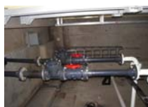
受水槽の緊急遮断弁(H)
