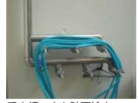
受水槽の水を計画給水
