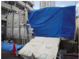
受水槽タンク破損
