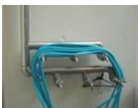
受水槽に設けた採水口(H)
